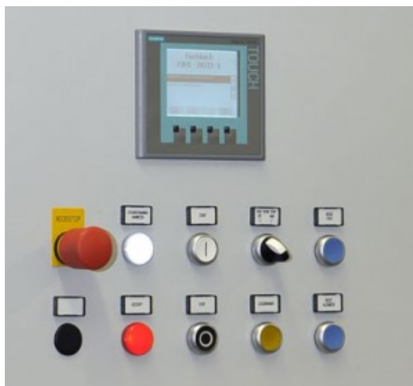
Slika 4. Primjer upravljačkoga ormara s upravljačkim panelom osjetljivim na dodir
