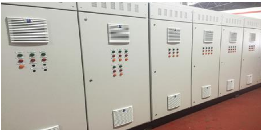
Slika 3. Primjer upravljačkih ormara za elektromotorne sustave
